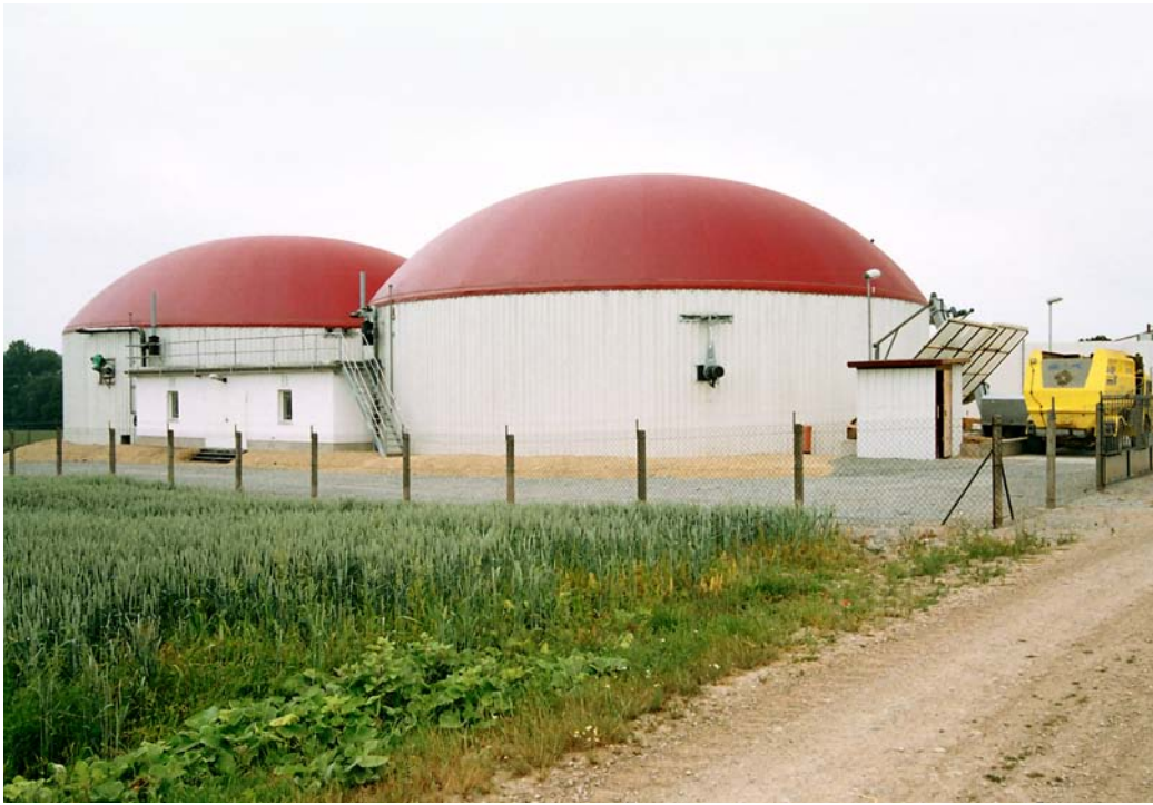
Biogasanlage mit Fermentern, Pump- und Steuerhaus: Konfliktpotential durch Rückübertragung der Planungshoheit an die Kommunen? Foto: JuwelTop/pixelio
